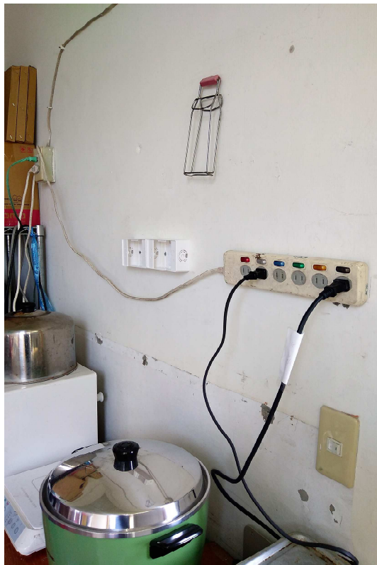
電源老舊更換 (17,850)
